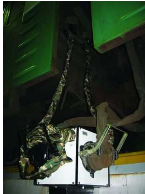
Подключение к электрическим цепям управления
